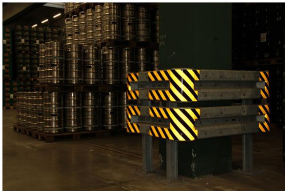
Säulenschutz einschließlich Signalfolie
